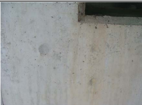
시점교대 균열(원주방향 - A1)
