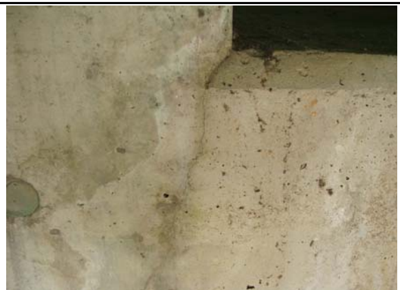
코핑부 균열(양평방향 - P16)
